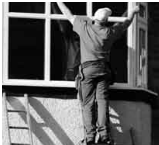
Vaak is de trap, ladder of steiger oorzaak van een ongeluk.
